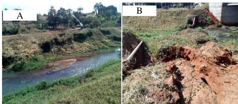
Figura 2. Erosões na área de estudo. A) Erosão de caráter fluvial por remoção de porções do solo. B) Erosão de caráter pluvial.
