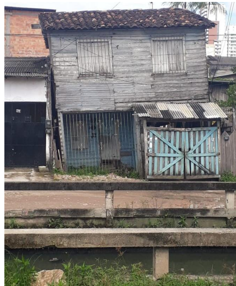
Figura 2 – Tombamento de residência devida gradual subsidência do terreno.
