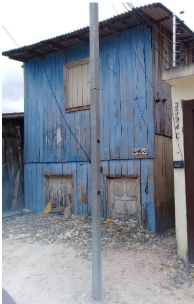
Figura 1 – Evidente desnível do solo com o piso da residência, causado devido a grande quantidade de material depositado para o aterro do terreno.
