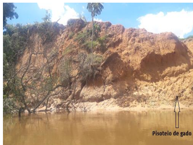
Figura 4: Erosão na margem direita do rio Sepotuba próximo a fazenda Porto do Campo
