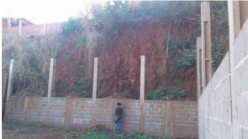
Figura 04 – Talude suscetível à processos de deslizamentos. Foto dos autores (2018).
