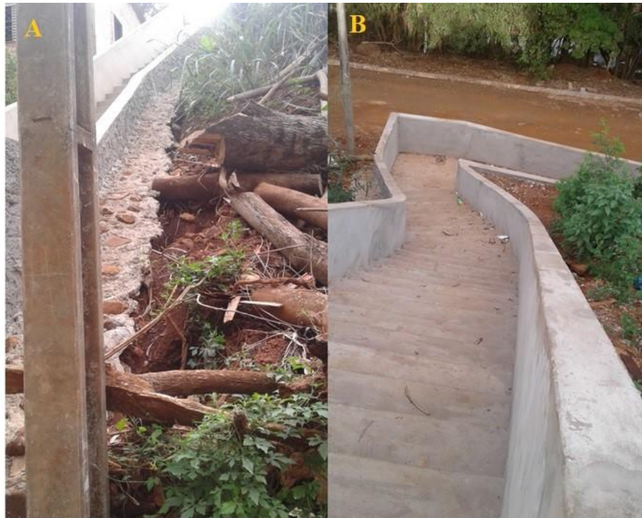
Figura 03 – Declividade acentuada e presença de materiais tecnogênicos. Em A, depósito de material tecnogênico e erosão, em B declividade acentuada de 20% Foto dos autores (2018).
