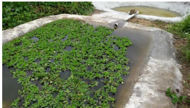
Figura 2 – Reservatório onde a água é colocada para a filtragem por meio de plantas.
