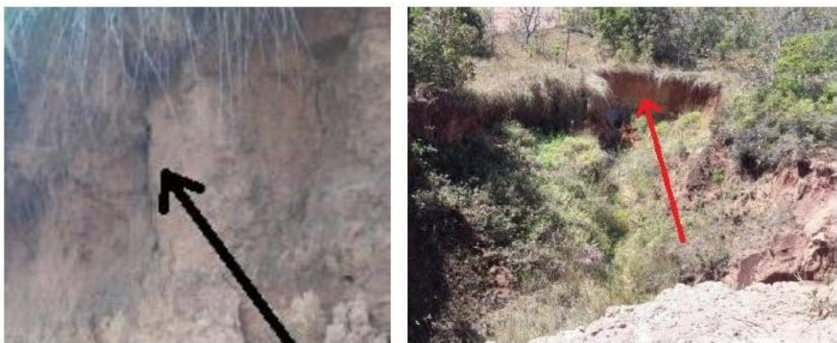
Figura 4: Trincas de tração no talude e abatimentos sucessivos na cabeceira da erosão.
