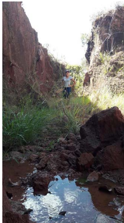
Figura 3. Instabilidade da erosão.
