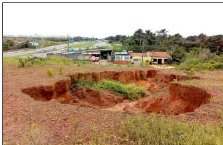
Figura 3 – Feição Erosiva ponto 2
