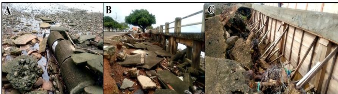
Figura 4 – Trabalho de campo realizado para a recuperação de dados primários. Fonte: os autores. Legenda: A – Galeria destruída pela força da maré do rio Amazonas; B – Área de passeio público em situação de progressiva subsidência do solo, seguido de solapamento das estruturas sintéticas edificadas na área; C – Estratégias recentes de construção em uma área afetada;
