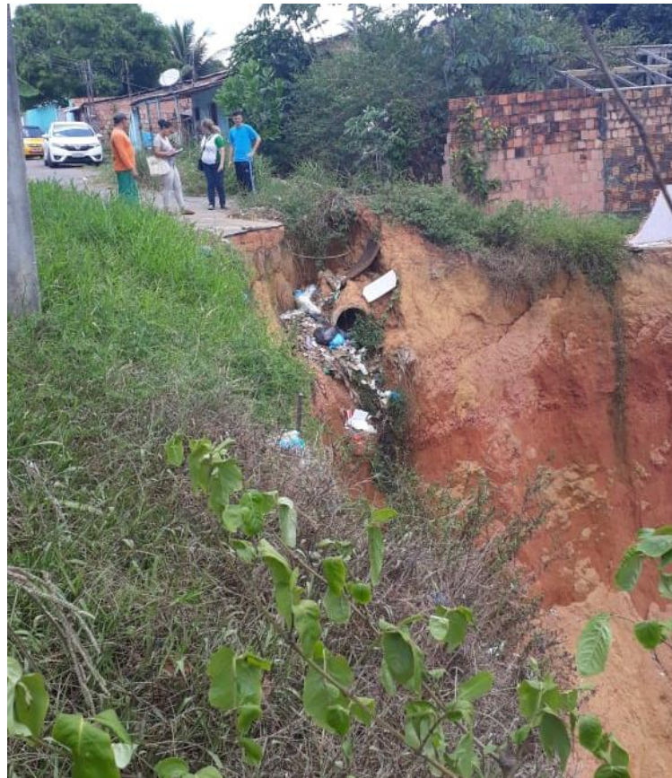
Figura 3: Danos causados pela retirada da cobertura vegetal no bairro Morada do sol
